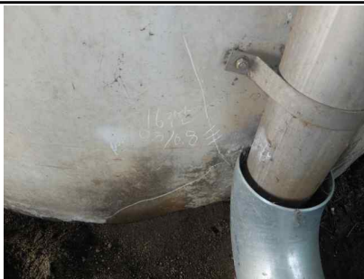
④ P1 기둥부 균열(cw=0.3mm)
