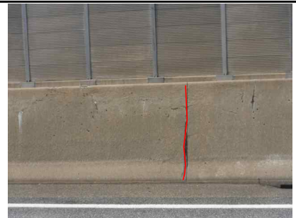
⑨ S6 중앙분리대 균열(cw=0.3mm)
