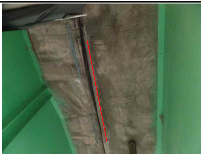
① S9 바닥판하면 균열(들뜸)
