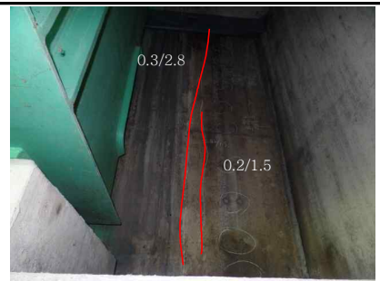
③ A2 홍벽 균열(cw=0.3mm)
