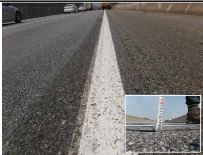
⑦ S2 교면포장 소성변형
